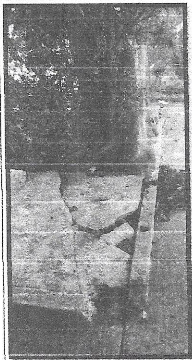
Foto 1. Vista lateral de un Tulipán africano, donde se puede apreciar los daños que provocan las raíces.
